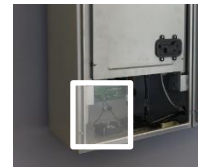
Energy meter input
